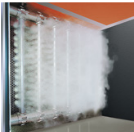
Паровое увлажнение в вентиляционной установке
