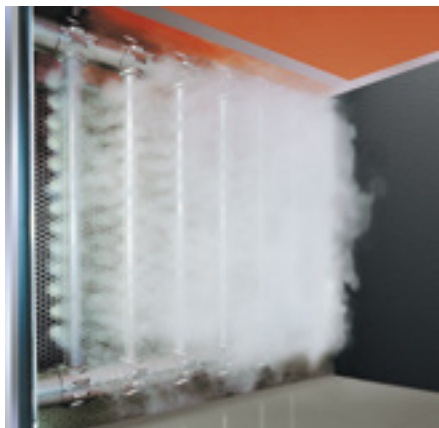
Паровое увлажнение в вентиляционной установке
