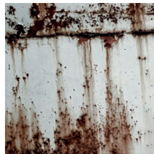
Защита от образования ржавчины и коррозии
